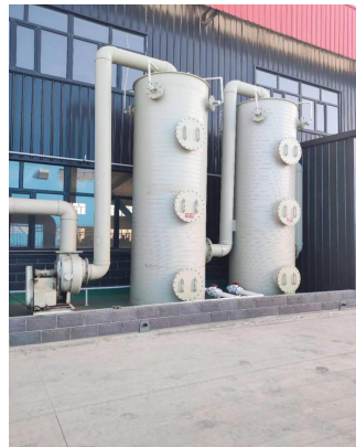
含氟废气喷淋塔
