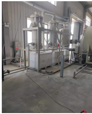
干法氟化冷凝塔
